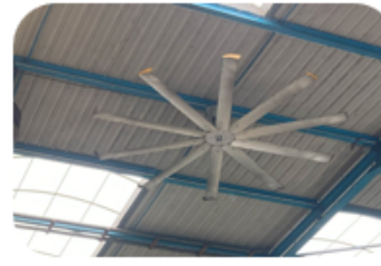
Brasseur d'air utilisé dans le technicentre de Villeneuve
